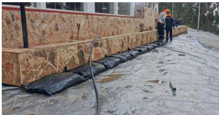
Instalación de Rapid Cover para el control de deslizamiento en taludes en la Biblioteca Gran Pajatén.
