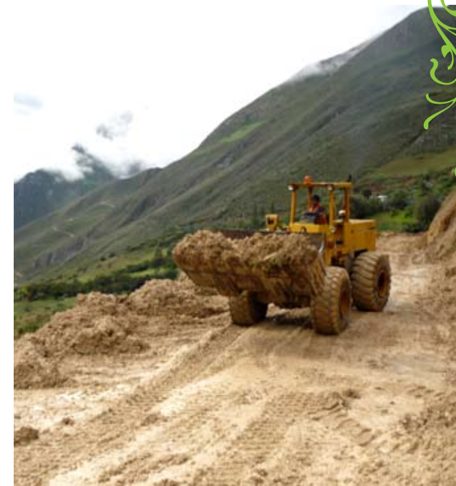
Mantenimiento y reparación de carretera en el sector Asia, distrito de Buldibuyo.
